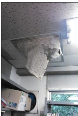
雨漏りが原因で落下した天井
