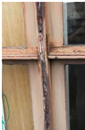
腐食が進む窓枠
