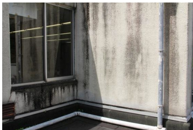
汚れが目立つ壁面
