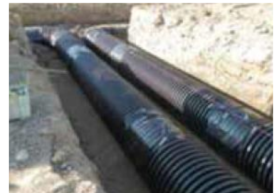
エネルギー供給設備
