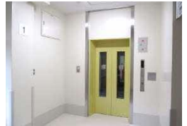
エレベーター
