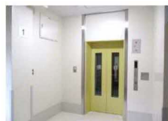
エレベーター
