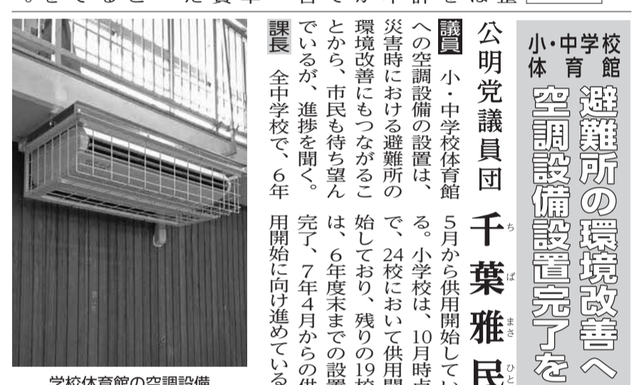
学校体育館の空調設備
