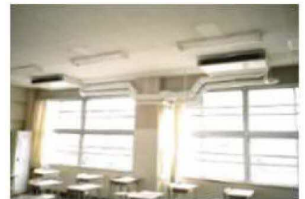
教室空調設備
