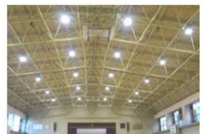
LED照明設備
