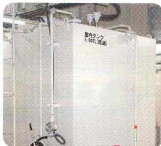
屋内オイルタンク
