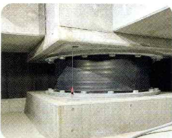
アイソレーター（積層ゴム支承）
