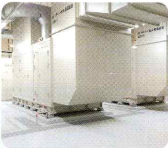
非常用発電機
