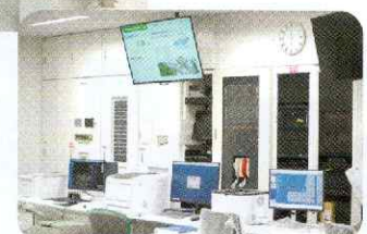
防災センター
